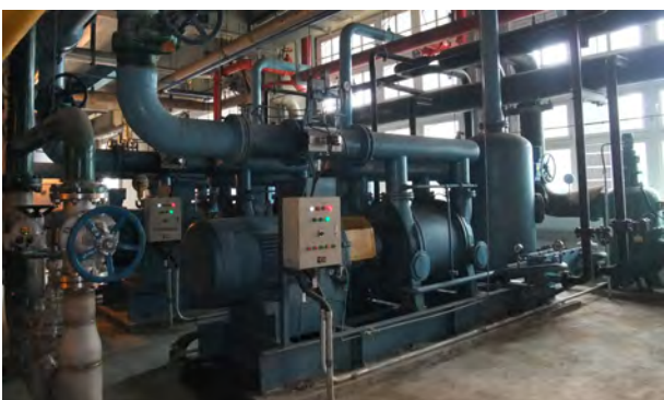
贵州兴义电厂2×600MW机组
